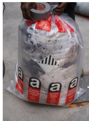
6 Kunststoffsack mit der Kennzeichnung «Asbest»
