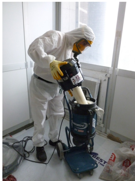
5 Periodische Kontrolle und Unterhalt des Apparats innerhalb eines abgegrenzten Bereichs durch eine spezialisierte Asbestsanierungsfirma
