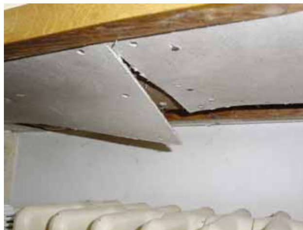
3 Asbesthaltige Leichtbauplatten als Brandschutzverkleidungen, z.B. bei Radiatoren
