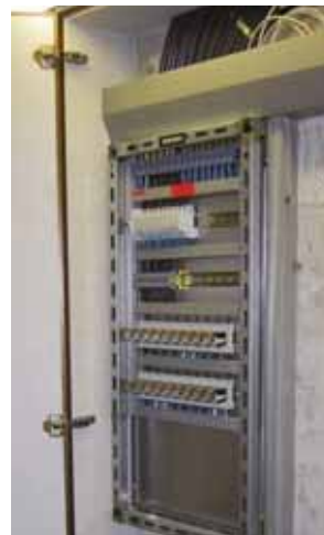
1 Asbesthaltige Leichtbauplatten, z. B. als Brandschutzverkleidungen im Inneren von Elektroschränken, hier Türverkleidung
